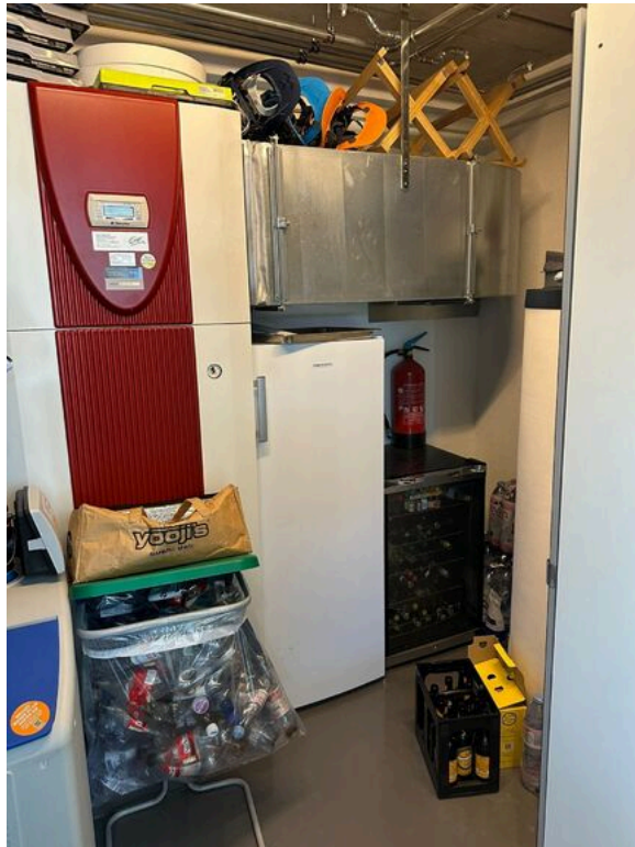
Technikraum im EG
