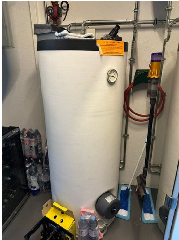
Boiler/Technikraum im EG
