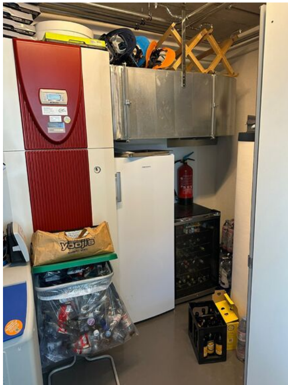
Technikraum im EG
